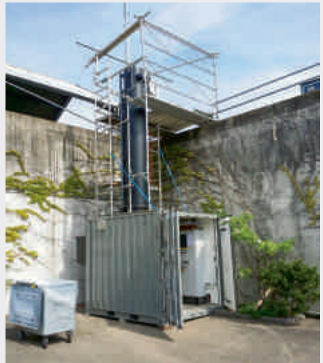
Fig. 3 Testanlage Nereda in Kloten-Opfikon Installation de test Nereda à Kloten-Opfikon
