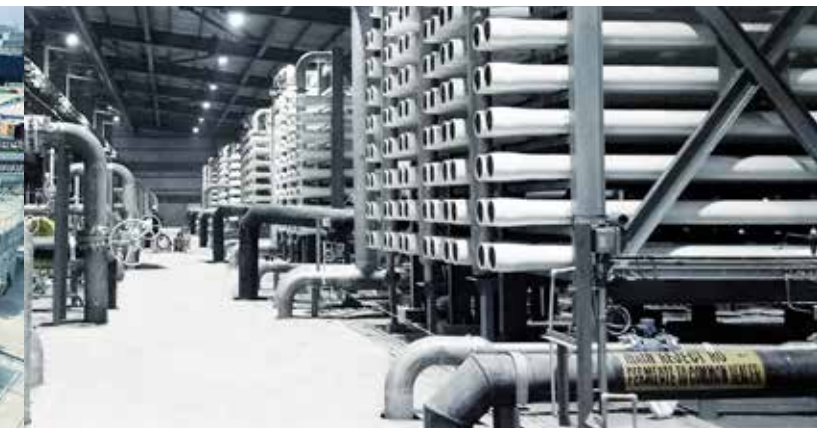
Wasseraufbereitung inkl. Recycling für Dahej Raffinerie, Indien inkl. UF und RO, 50.000 m³/d.
