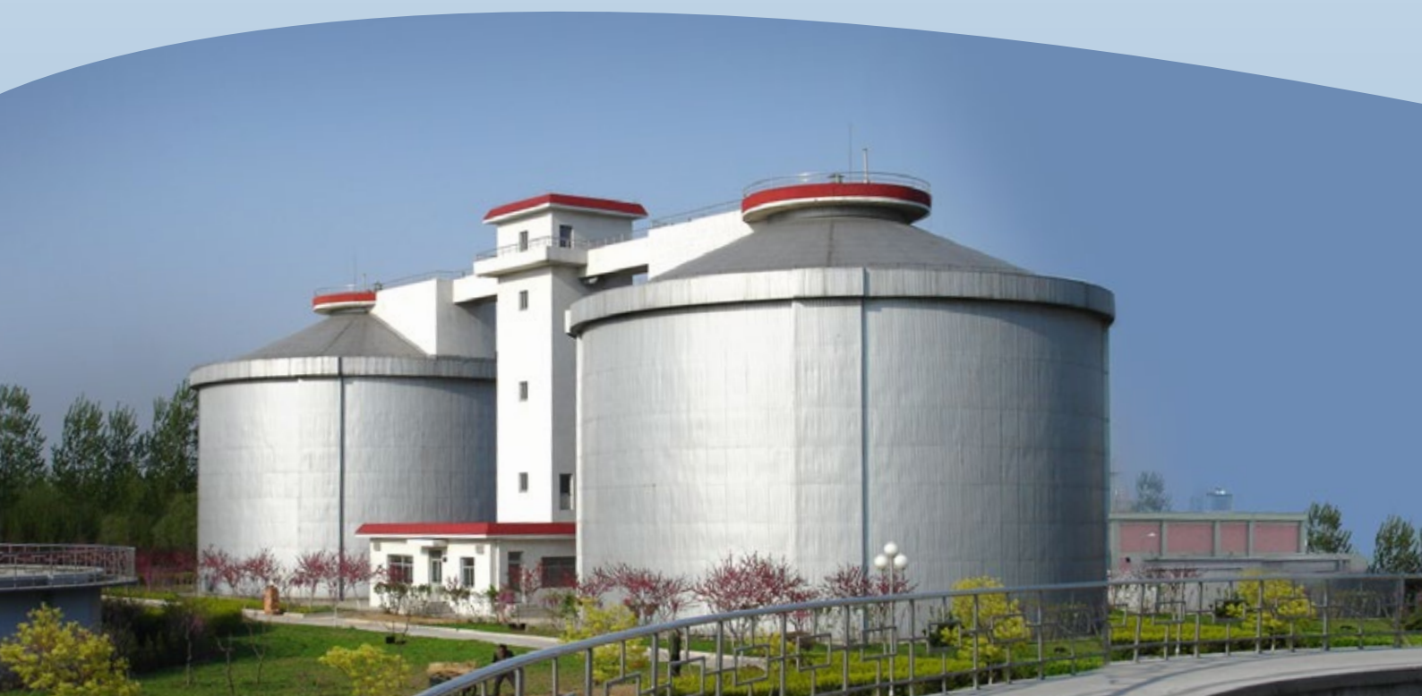
Classic digester (Weifang WWTP, P.R. China, 100,000 m 3 /d)
