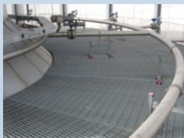
Homogénéisation : système d'injection de gaz
