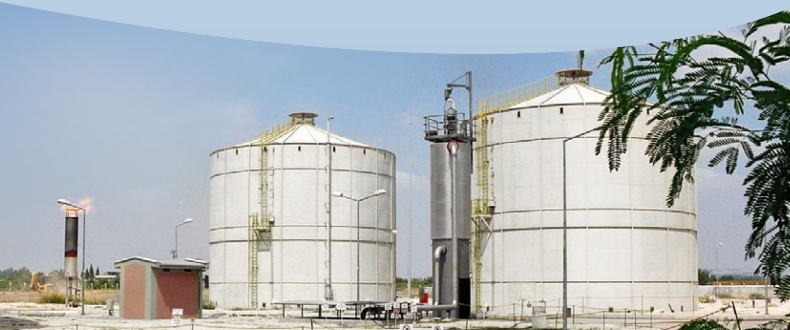
Elimination du soufre dans le biogaz, gazomètre, torchère
