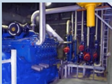
Centrale de cogénération
