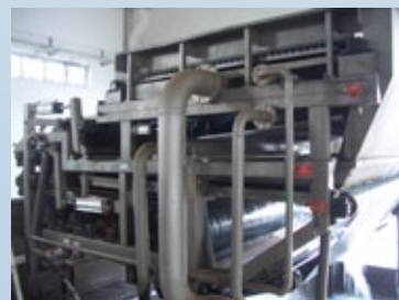
Schlamm entwässerung (Bandfilterpresse)
