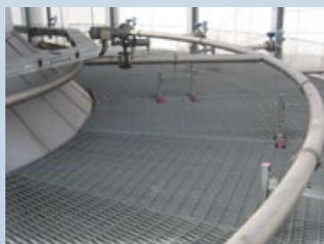
Schlammumwälzung mit Gaseinpressung
