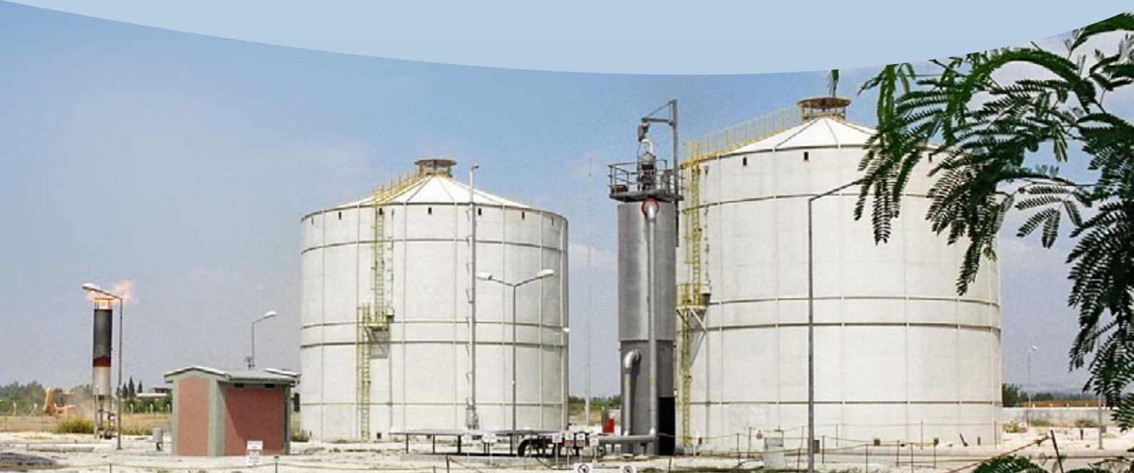
Biogasentschwefelung, Gasspeicher, Gasfackel
