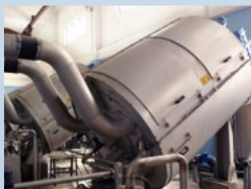
Уплотнение осадка сточных вод (механическое)
