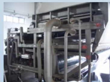
Обезвоживание осадка (ленточные фильтры-прессы)
